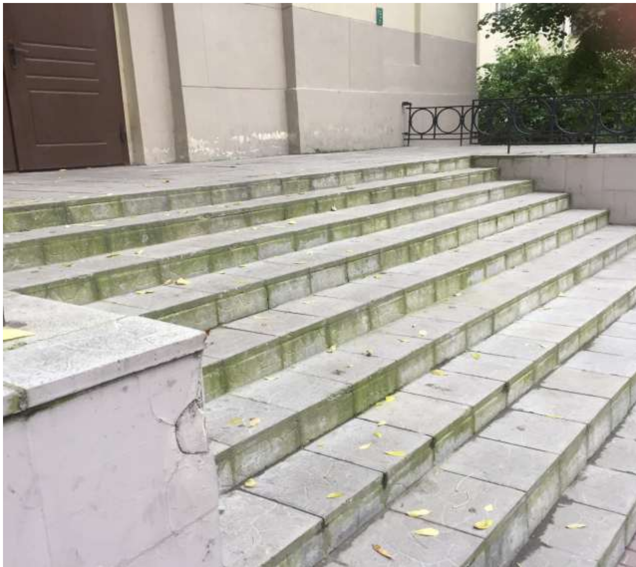
Входной узел. Требуется реконструкция.
